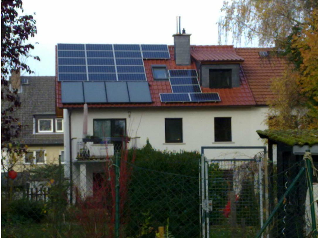
Photovoltaik mit Solarthermie-Flachkollektoren auf einem Reihenhaus.
